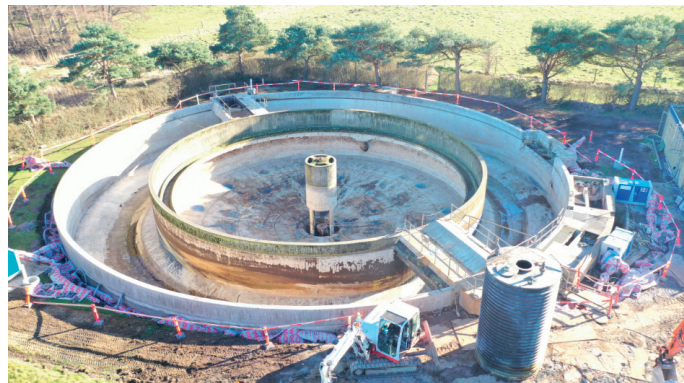
Billede som viser ombygningen af proces tank til forsinkelsesbassin på Dronningmølle Renseanlæg
