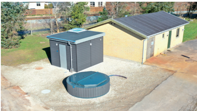
Den nye pumpestation plus hus med ventiler og SRO/EL styring på Vejby
